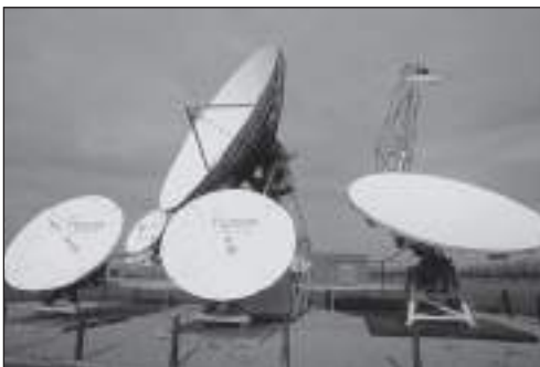
Stații terestre de retransmisie din componența liniilor cu unde radio
