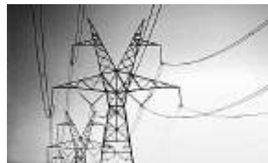
Рис. 2.9. Алюминиевые провода в высоковольтных линиях электропередач
